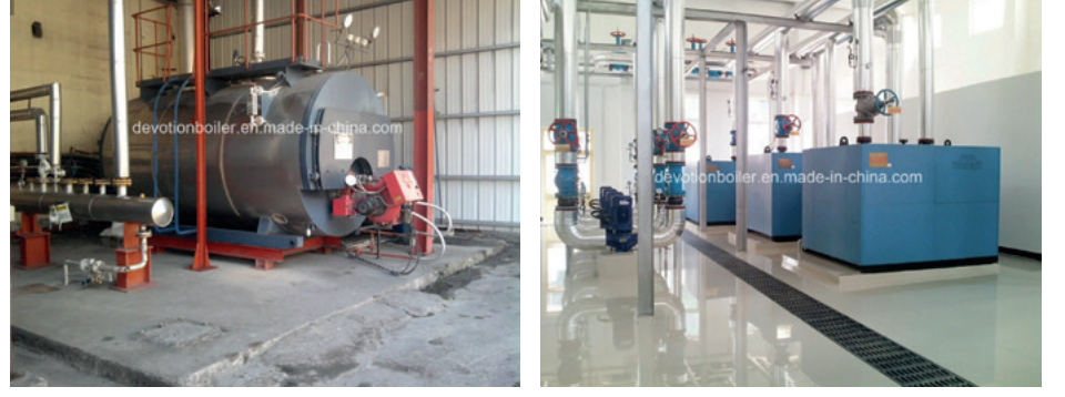
Şekil 80: 2.000 kg/h buhar kazanı; sol: doğalgaz kazanı, sağ: elektrikli kazan (üç set)
